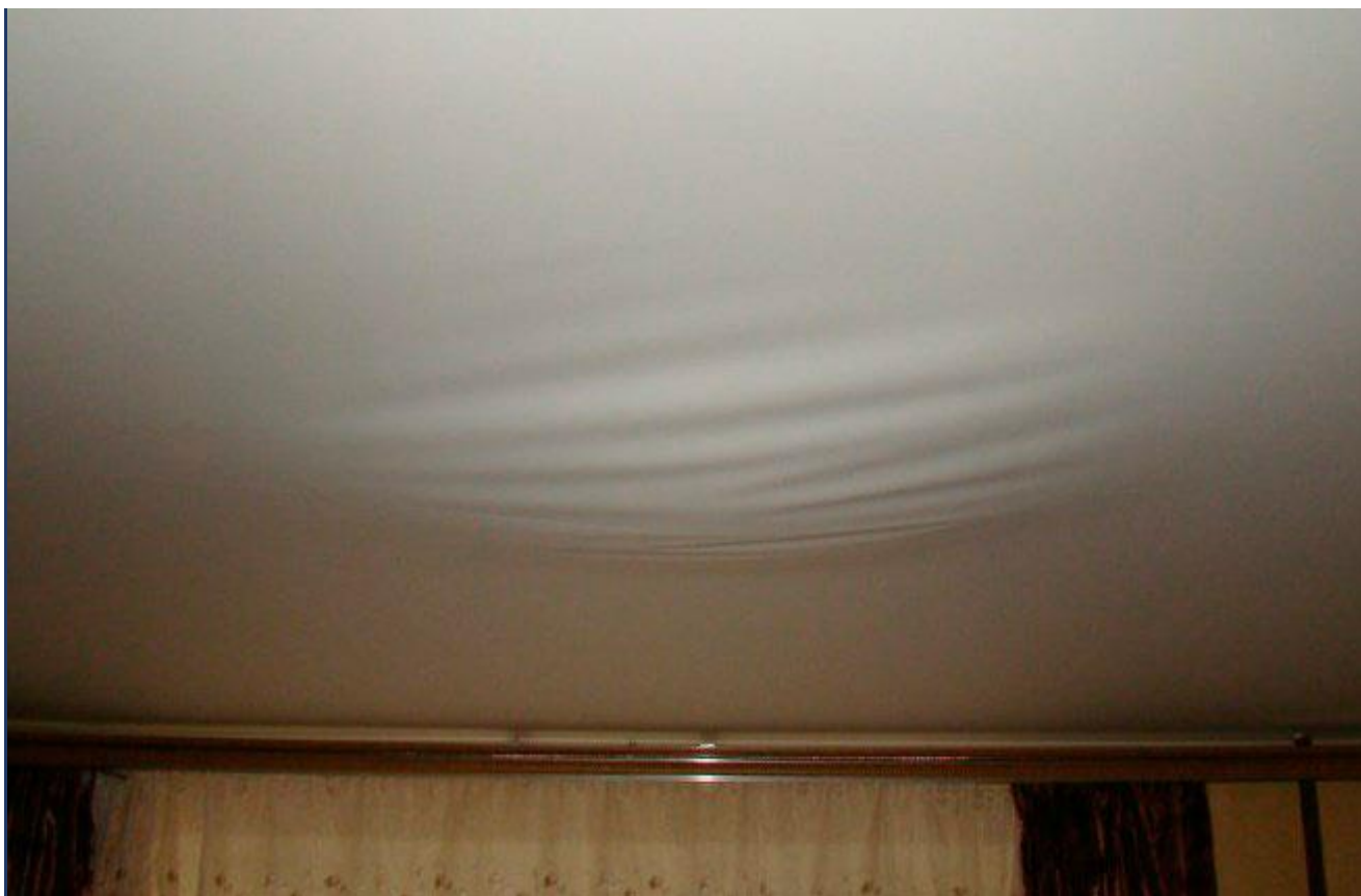
Фото 2. Провисание натяжного потолка
